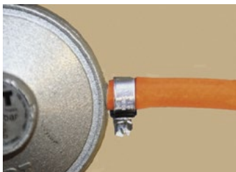
Slanganslutning vid reduceringsventil. Foto: MSB
